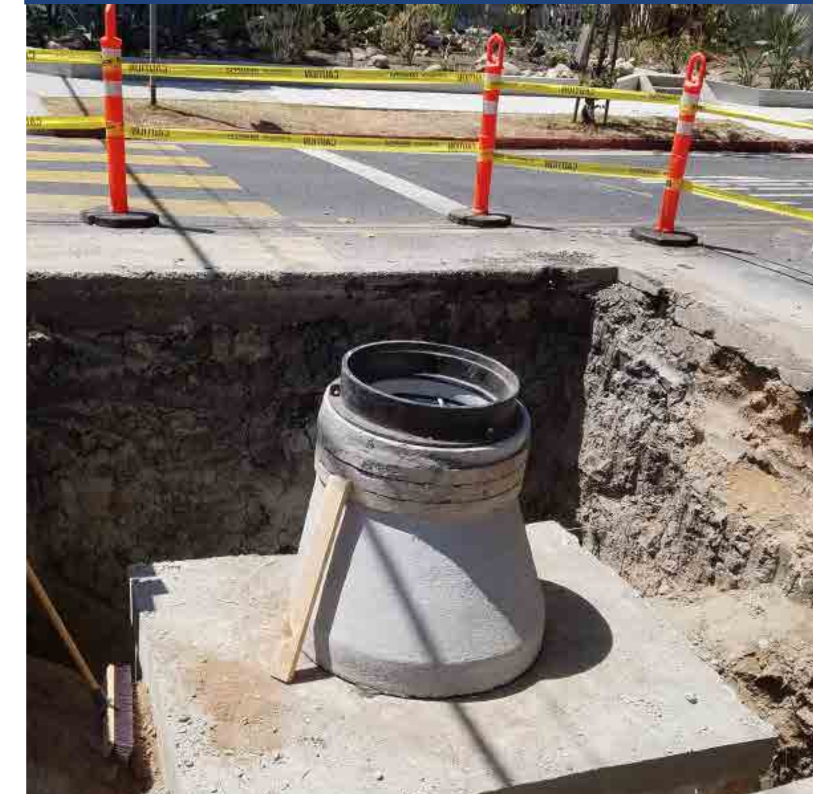
Estructura de Desvío
